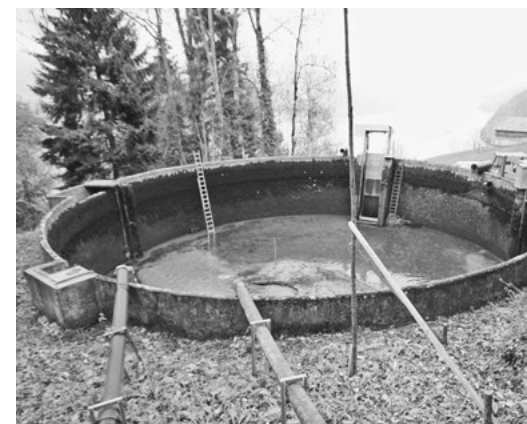
Ausgleichsbecken Napf, entleert für Reinigungsarbeiten.
