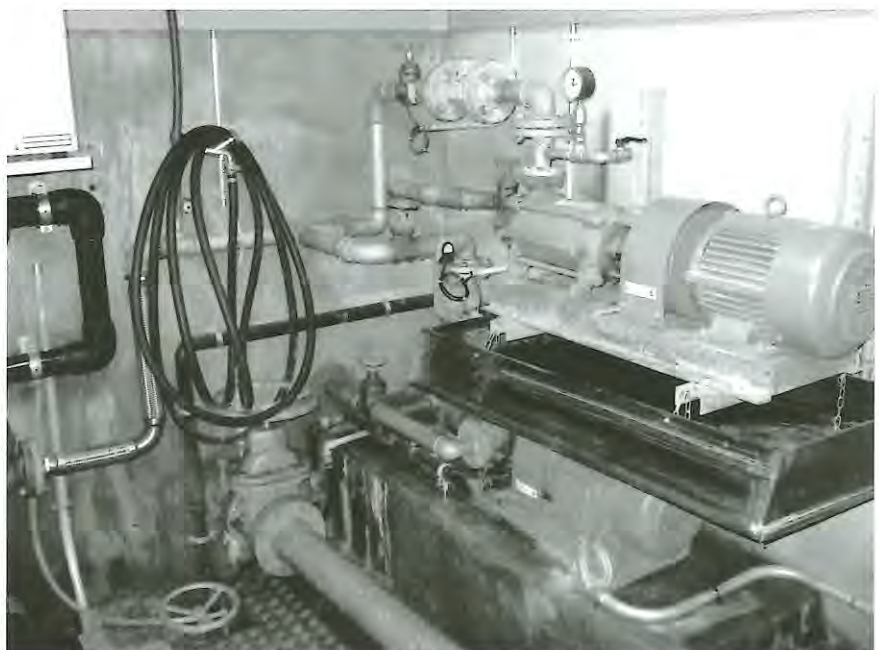
Pumpenanlage im Pumpwerk Tannibüel
