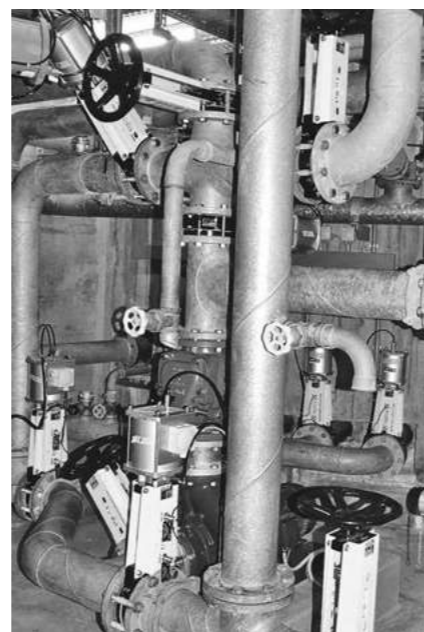
Ersatz Schieber Faulanlage.
