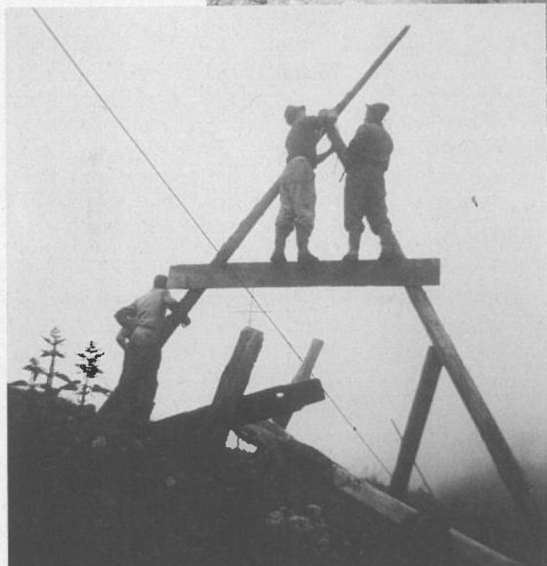
Seilbahn für die Erstellung einer Alphütte
