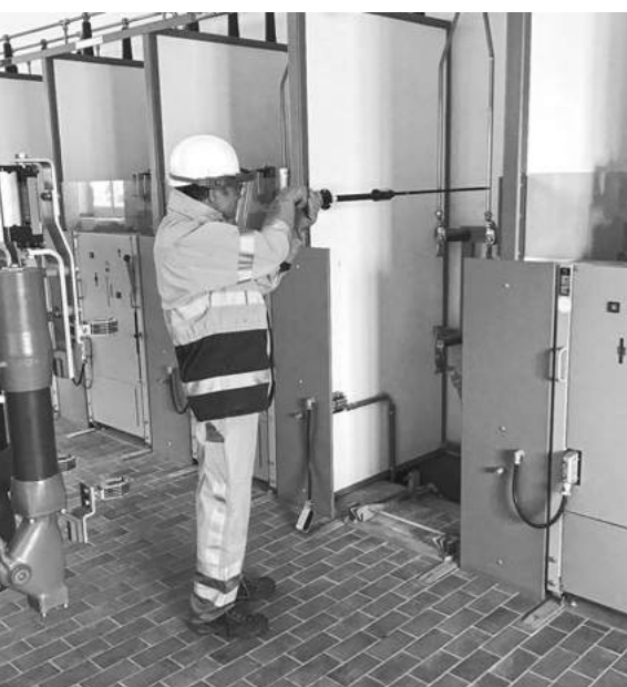
Die korrekte Anwendung der PSA (persönlichen Sicherheitsausrüstung) ist ein wichtiges Element bei der Arbeitssicherheit. Christian Hess bei der Spannungsprüfung an einer Mittelspannungsanlage.
