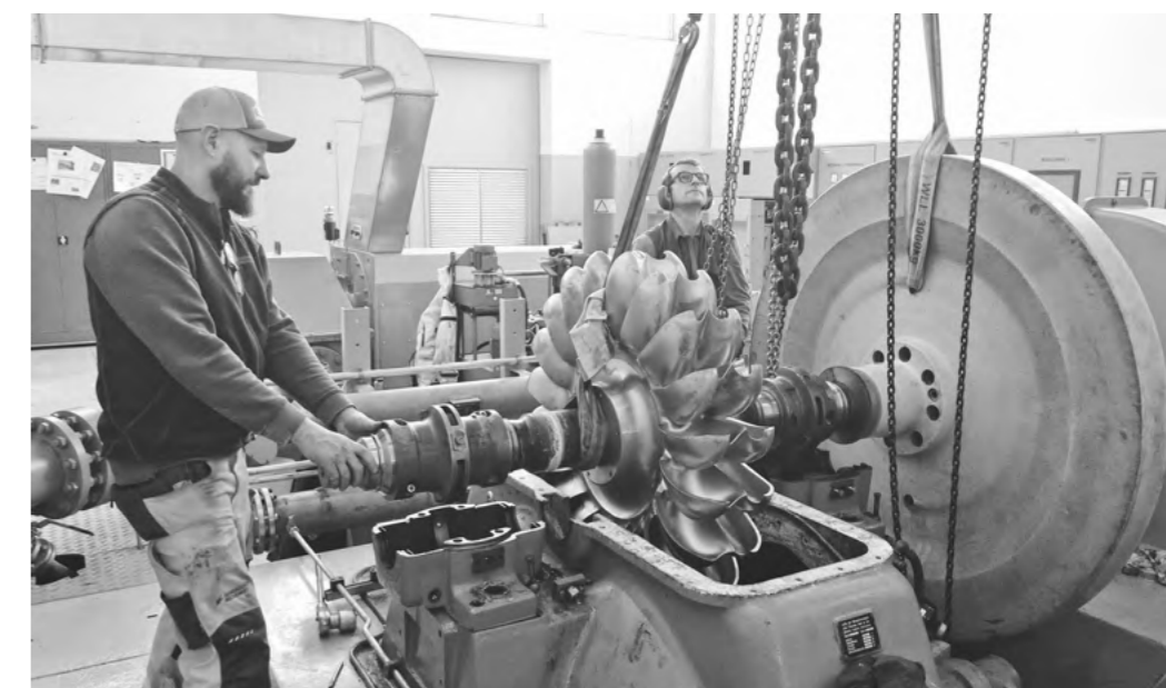
Die Turbine musste aufgrund des Schadens demontiert werden.
