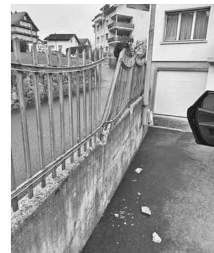
Schulweg, Schaden an Geländer durch Unbekannte verursacht.
